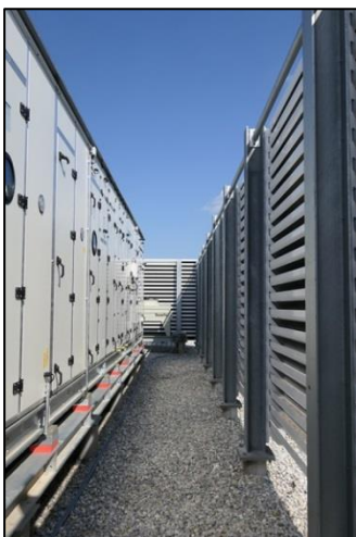
Abluftanlage der Küchenlüftung auf dem Dach der Zentralen Mitte
