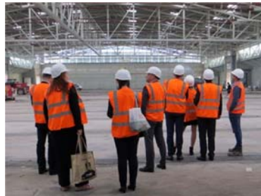
2 Daniel Reuter (rechts) erklärte den Teilnehmern der Baustellenführung die Besonderheiten des Großprojekts.
