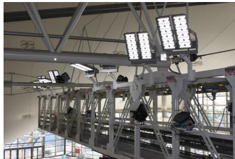
Neue LED-Strahler mit 210.000 Lumen am Beleuchtersteg.
